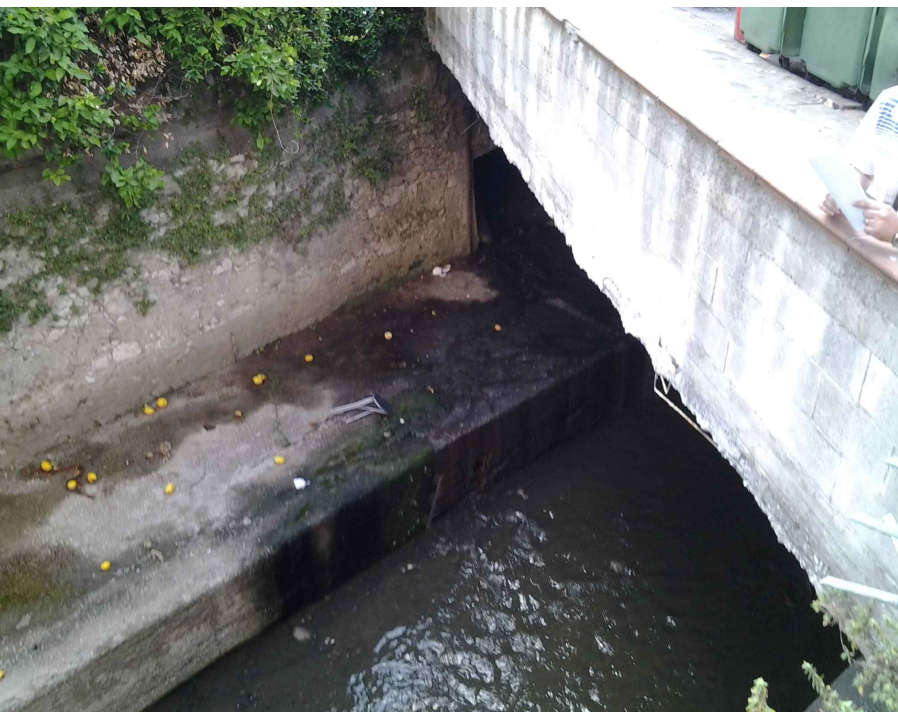
C33TLA08 Incrocio via Matteotti-via Citarella: n.1 scarico acque reflue nel tratto a giorno del Torrente Cavaiola
