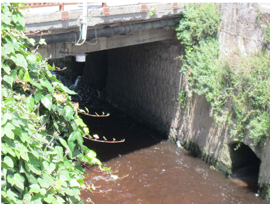
C33TLA01- C33TLA02- C33TLA04 Via San Francesco: n.3 scarichi acque reflue nel tratto a giorno del Torrente Solofrana
