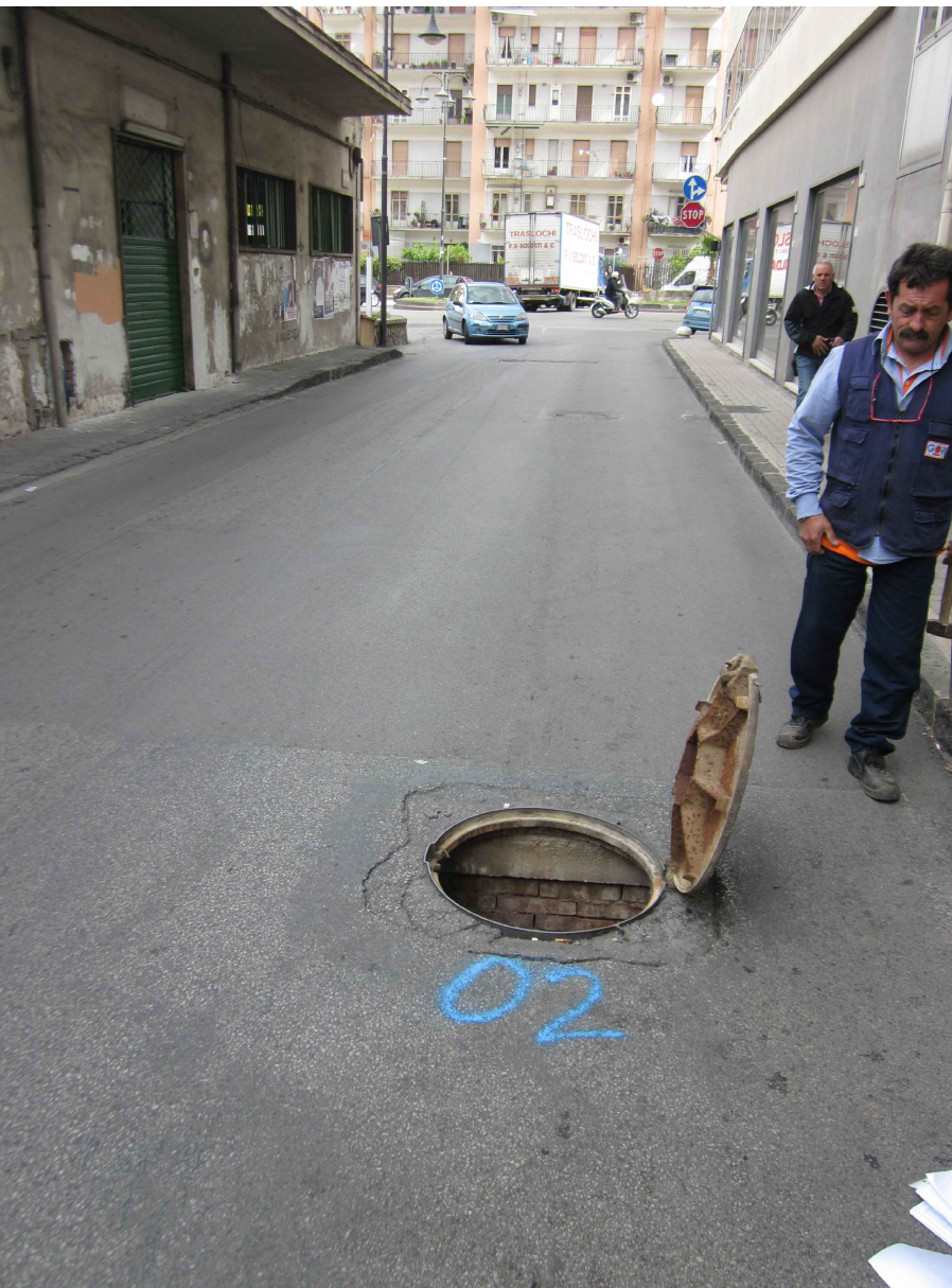
C33TLA11 Incrocio via Atzori-via Pentapoli: n.1 scarico acque reflue nel tratto tombato del Torrente Cavaiola
