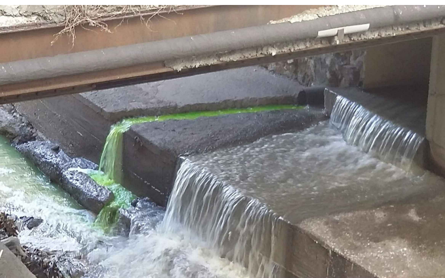
C33TLA06 - C33TLA07 Via Martinez: n.2 scarichi acque reflue nel tratto a giorno del Torrente Cavaiola
