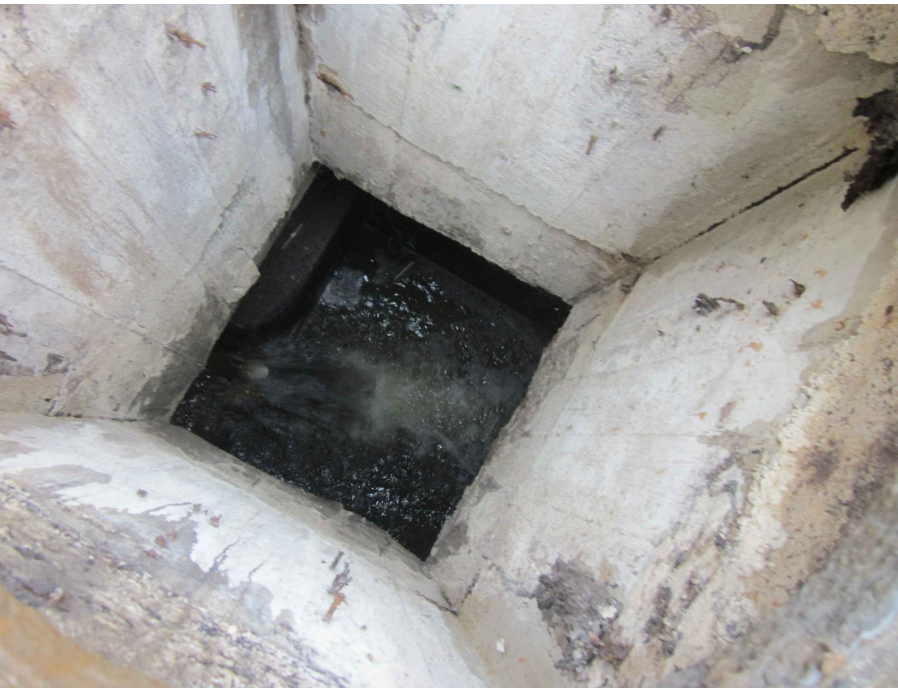
C33TLA09 via Fucilari, collettore proveniente da via Atzori: n.1 scarico acque reflue nel tratto tombato del Torrente
