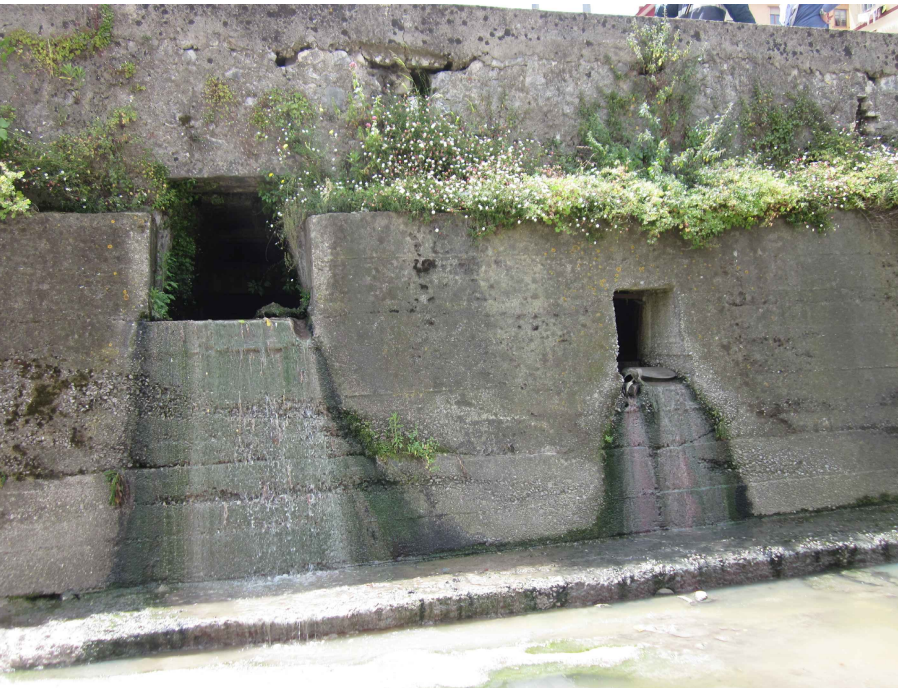
C33TLA13 - C33TLA14 Incrocio via Atzori-via Riccio: n. 2 scarichi acque reflue nel tratto a giorno del Torrente Cavaiola
