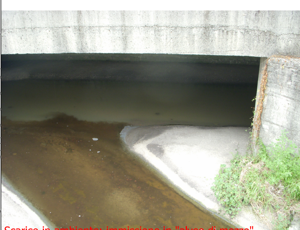
Scarico in ambiente, immissione in "alveo di mezzo"
